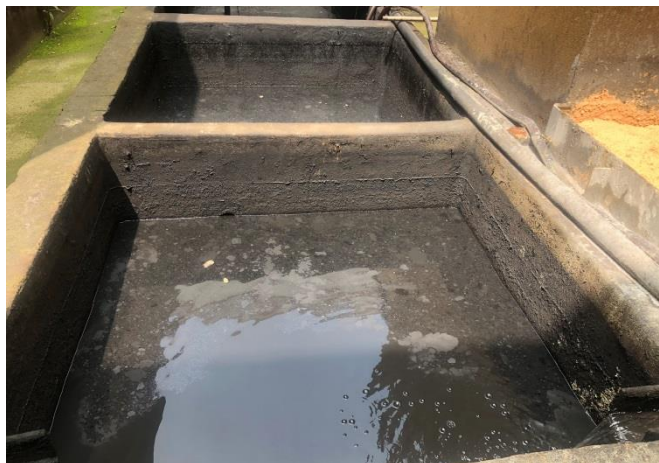
图 4.3-4 生产废水集水池现场图
