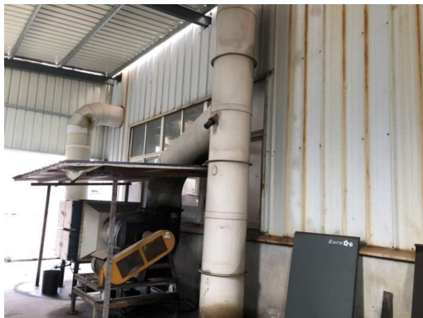
图 4.3-1 冷镭废气处理（油雾净化器）设备现场图
